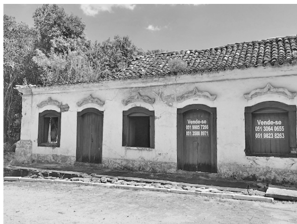
Figura 3 – Casa da Rua Demétrio Ribeiro, antiga Câmara de Vereadores, em estado de arruinação Fonte: Acervo do autor
